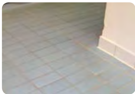
Sur le sol de ce vestiaire : la stagnation des eaux encourage le développement des microbes. Les joints colorés résistent au passage de l'autolaveuse et du produit.
